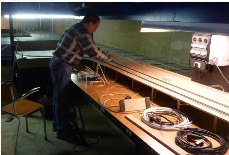
Foto 14 Aansluiten testspoor in de controleruimte
